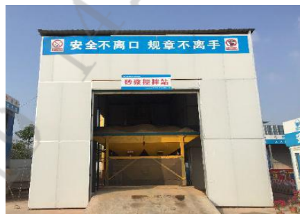
混凝土搅拌站隔声棚
