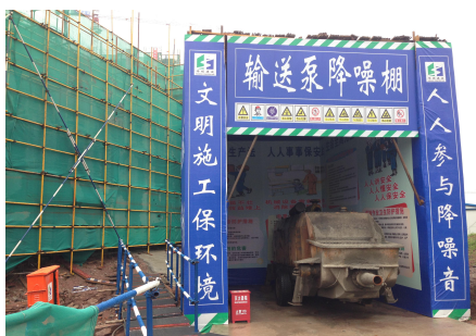
混凝土输送泵隔声棚
